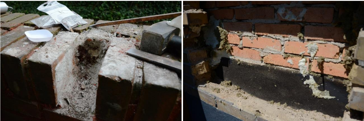
Foto 2: Undersøgelser af teknisk tilstand af murværk (Foto tv.: Udtagning af sten fra fritstående mur i kollegiebygning fra 1950, hvor det viser sig, at mørtlen endnu ikke er færdighærdnet. Foto th.: Nedrivning af formur i parcelhus fra 1950'erne opmuret med maskinsten og svag kalkmørtel for dels at se tilstanden af bagmur samt vurdere egnethed for energiforbedring af hulmuren. (Fotos Teknologisk Institut)
