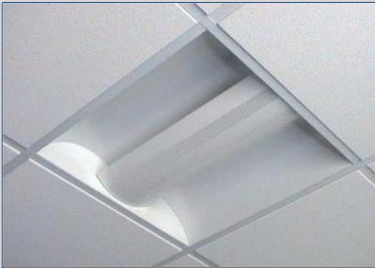
EKSISTERENDE ARMATUR– MED UDSKIFTELIGE LYSKILDER
